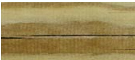
FISSURES ET FENTES
