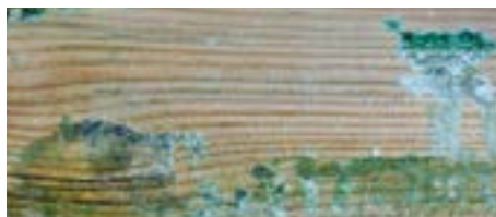
REMONTÉES DE SELS
